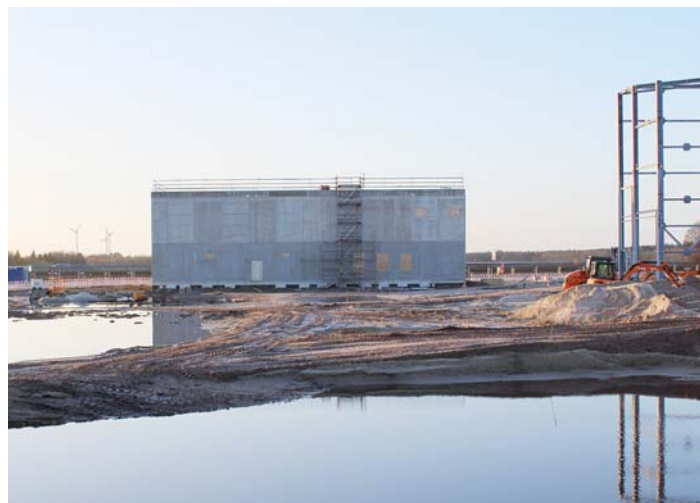
Die Hallenkonstruktion der Umrichterstation „TenneT“ in Dörpen-West an der A31 steht bereits. Voraussichtlich im Jahr 2017 wird „DOLWIN3“ abgeschlossen werden. Foto: Inge Meyer
